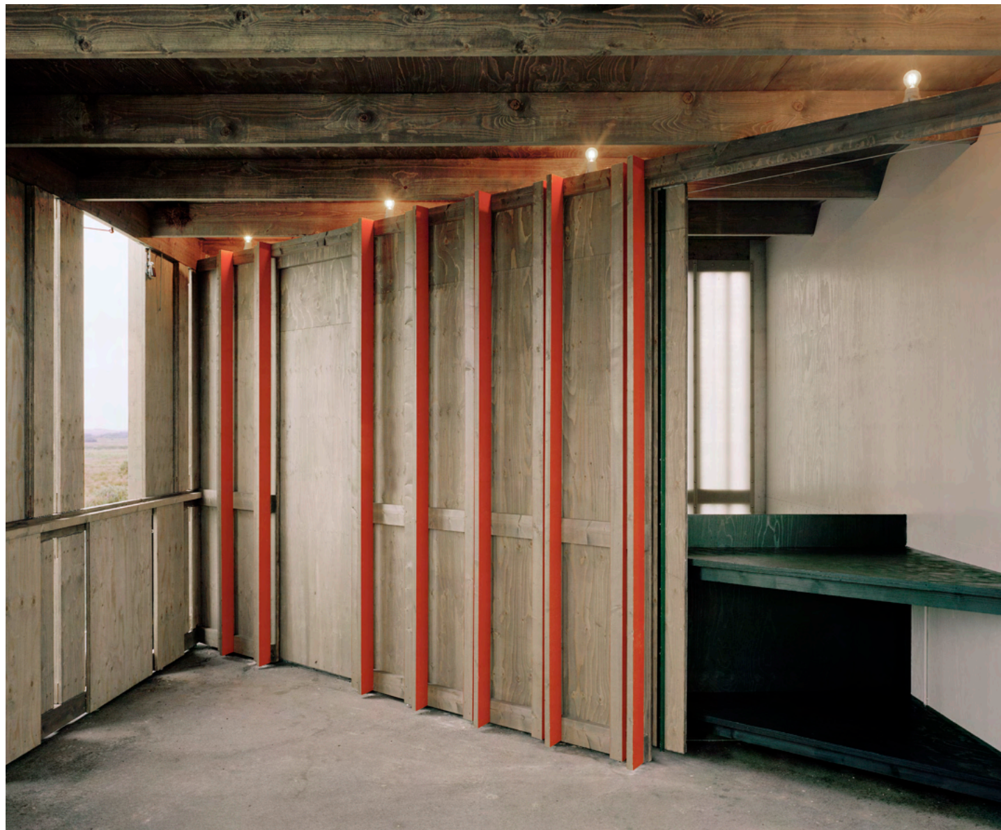
Pumpestation Øst, interiør. Fotos: Rasmus Norlander.
